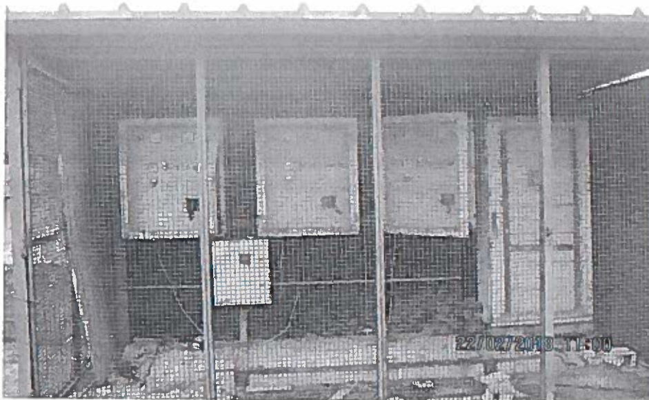
Foto n.6 – Quadro elettrico a servizio dell'impianto di sollevamento fuori uso per mancanza di cavi di alimentazione elettrica
