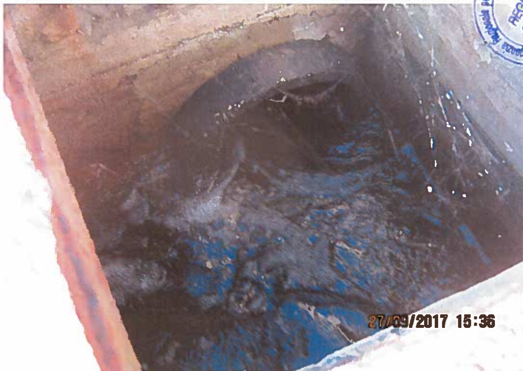
Foto n. 4 – Una delle vasche di raccolta dell'impianto di sollevamento. Si evidenzia la condotta di troppo pieno (scolmatore) che permette lo sversamento delle acque, nel torrente Ciachea, quando le stesse non sono pompate nella condotta sottomarina.
